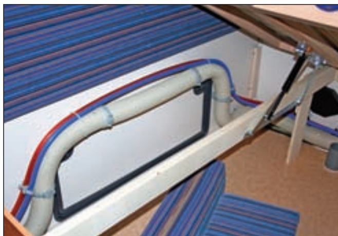
Fin detalj: Både varmlufttrør og vannrør er lagt over luken inn til lasterommet under dobbeltsengen, for å hindre frost.
