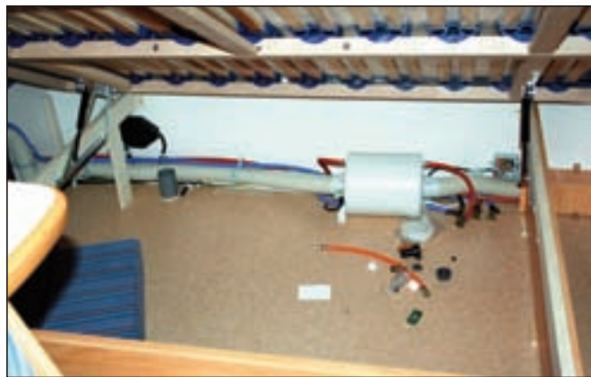
TrumaTherme-berederen er som i de fleste vogner montert for langt fra gassvarmeren.
